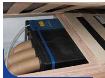
Vestavná klimatizace s rozvodem po karavanu.
