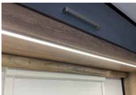
Interiérové LED osvětlení.
